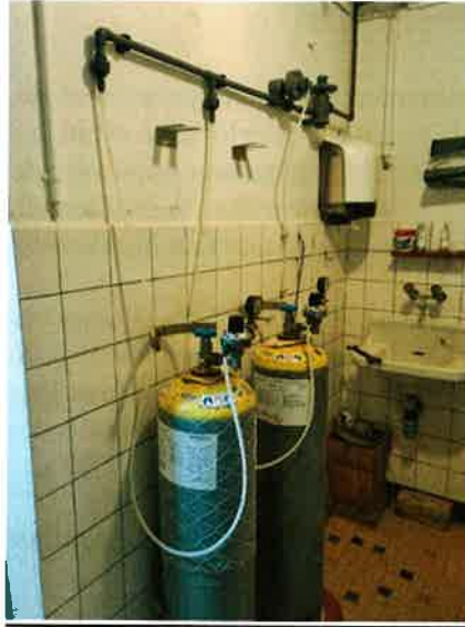
Bouteilles de chlore présentes à la station de pompage de la Gerlette
